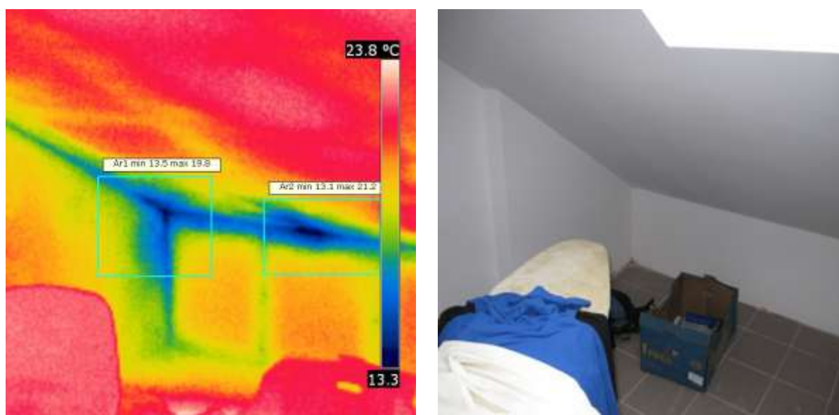
Rys. 17 Termogram wadliwej izolacji styku ścianki kolankowej oraz dachu
